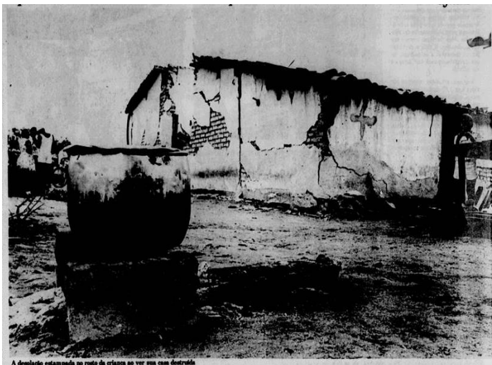
Figura 20 – Rachaduras visíveis nas residências em João Câmara
