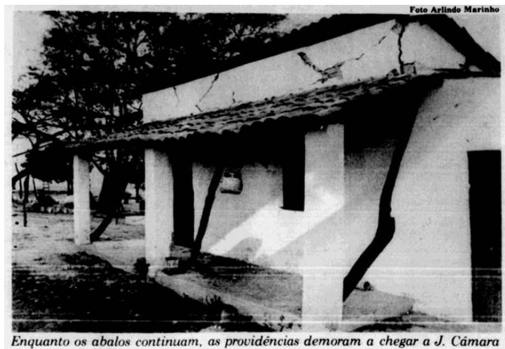
Figura 11 – Casas com rachaduras após os abalos sísmicos.
